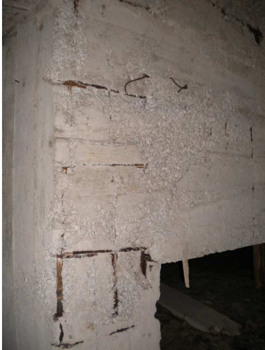
Nidi di ghiaia presenti nel calcestruzzo in fondazione di pilastri e travi, ferri a vista ossidati
